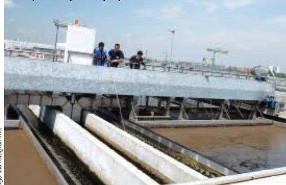
Un depuratore per l'acqua potabile
